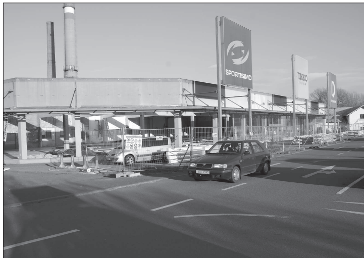
Rekonstrukce vyhořelého obchodního centra na Štefánikově ulici se potáhne celou zimu. Znovuootevření proběhne pravděpodobně v květnu.
