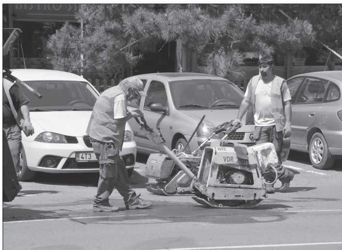
Opravy výtuků na komunikacích v Kopřivnici provádí Slumeko i v místech, které byly v zimě provizorně vyspraveny. FOTO: DANA HOĐÁKOVÁ
