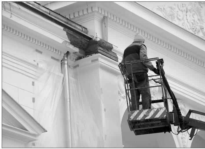
Poškozená fasáda Ringhofferovy vily se v minulém týdnu dočkala první opravy. Radnice stále čeká na nezávislý posudek vloni provedené rekonstrukce. FOTO: DAVID MACHÁČEK
