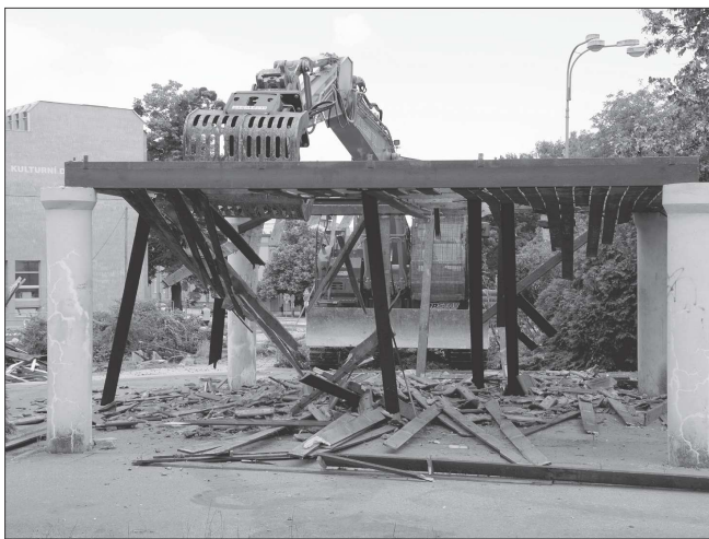
Demoliční stroje se do altánu v centru Kopřivnice zakously 30. června krátce po 13. hodině. Dnes už po stavbě z konce 80. let není ani památka. FOTO: D. MACHÁČEK
