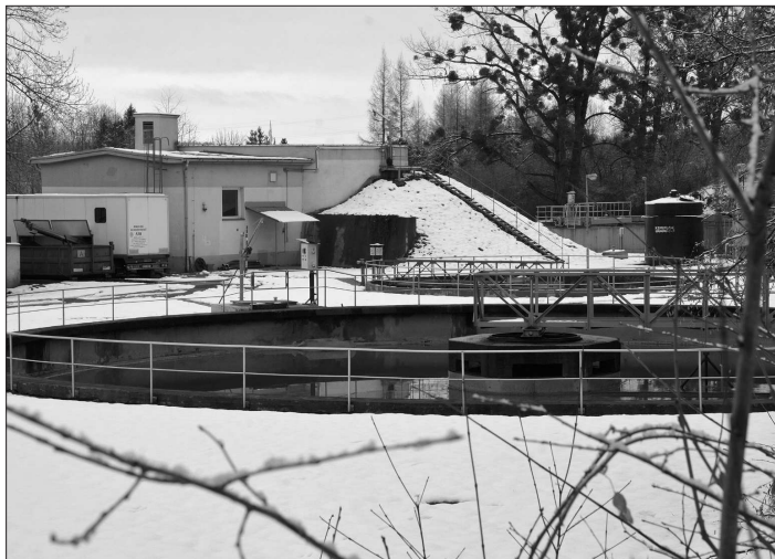
V letošním roce byla dokončena dosazovací nádrž, která má zvýšit kapacitu kopřivnické čističky odpadních vod před napojením dalších místních částí.
