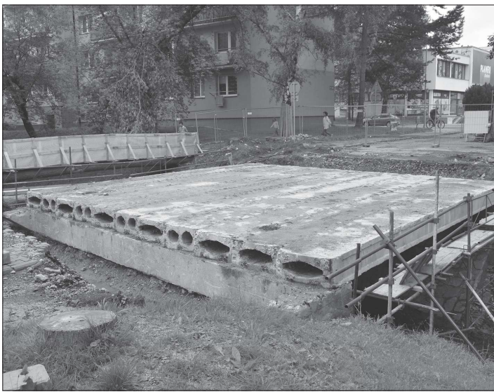
Až demoliční práce umožnily posouzení stavu příčných nosníků mostu na ulici Kpt. Jaroše. Statik doporučil jejich kompletní výměnu, což stavbu značně protáhne. FOTO: DAVID MACHÁČEK
