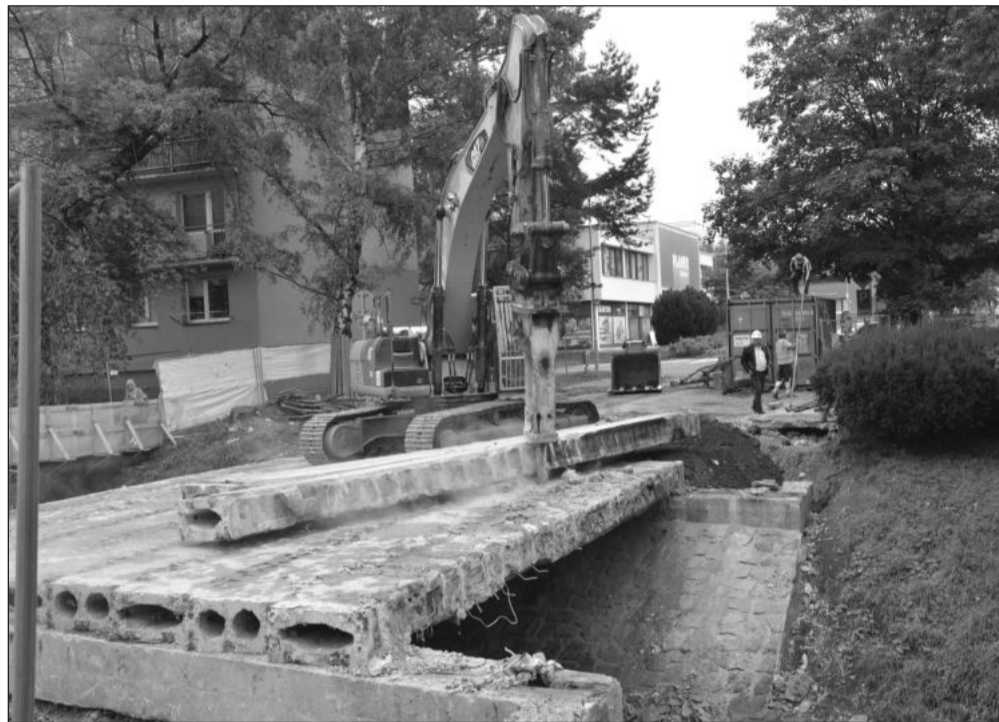
Po rozhodnutí o změně technologie, která bude využita při rekonstrukci mostu na ulici Kpt. Jaroše, začala demolice původních, nevyhovujících konstrukcí mostu. FOTO: DAVID MACHÁČEK
