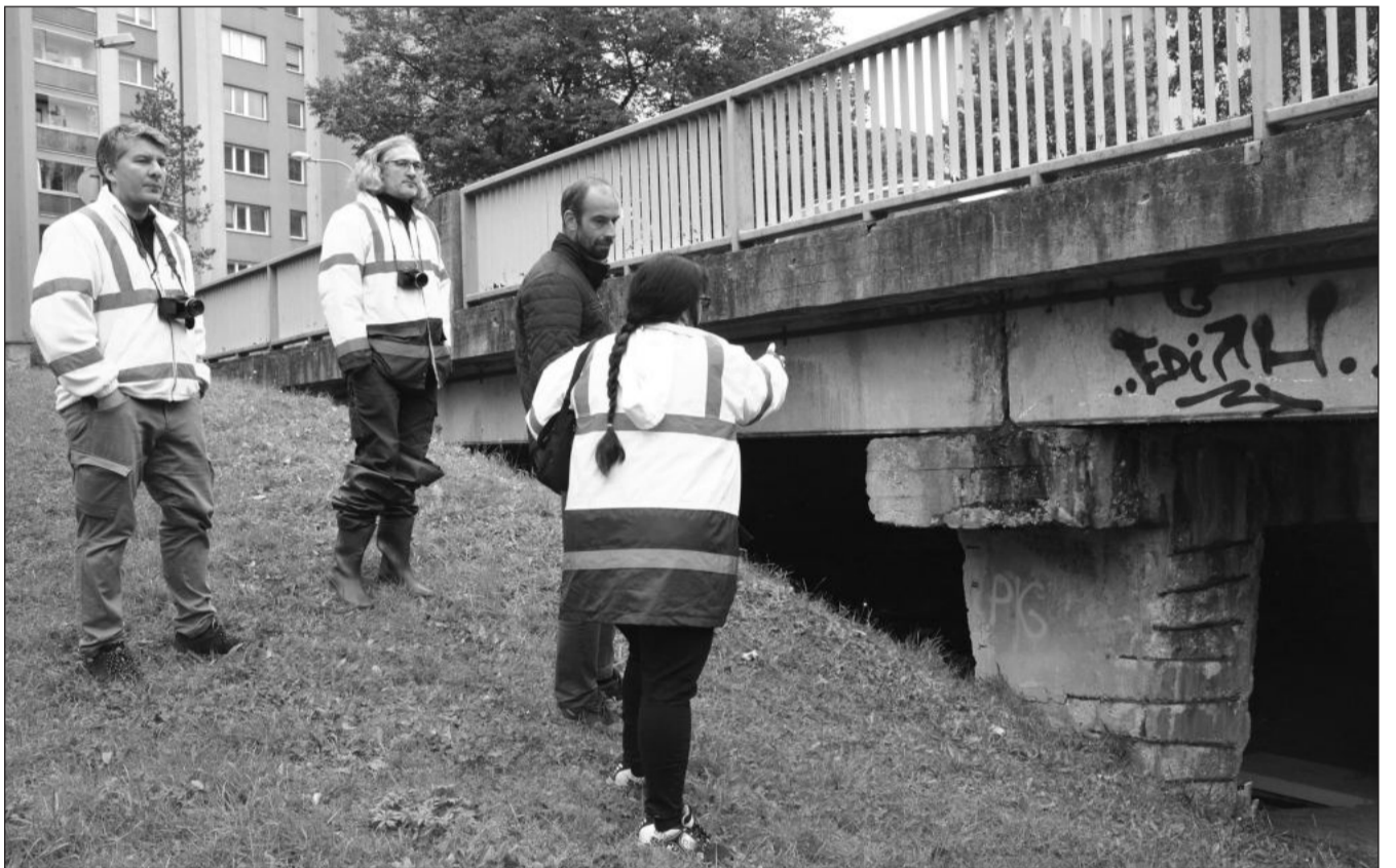
Pravidelné kontroly mostu na ulici Erbenově už několik let upozorňují na jeho nevyhovující stav. Na příští rok plánuje kopřivnická radnice na tomto místě investovat desítky milionů korun na rekonstrukci či stavbu nového mostu. FOTO: DAVID MACHÁČEK
