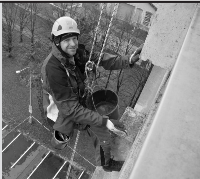
Sanační práce na fasádě budovy městského úřadu provádí specialisté na výškové práce. FOTO: DAVID MACHÁČEK
